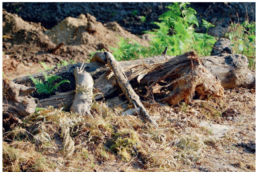
Exemple de ce qui a été trouvé dans la digue au niveau de l'ancien tuyau de vidange.
