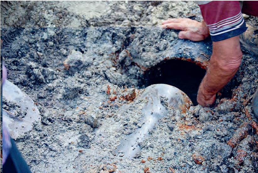
Tuyau plastique entrant dans une buse ciment plus grande et percée.
